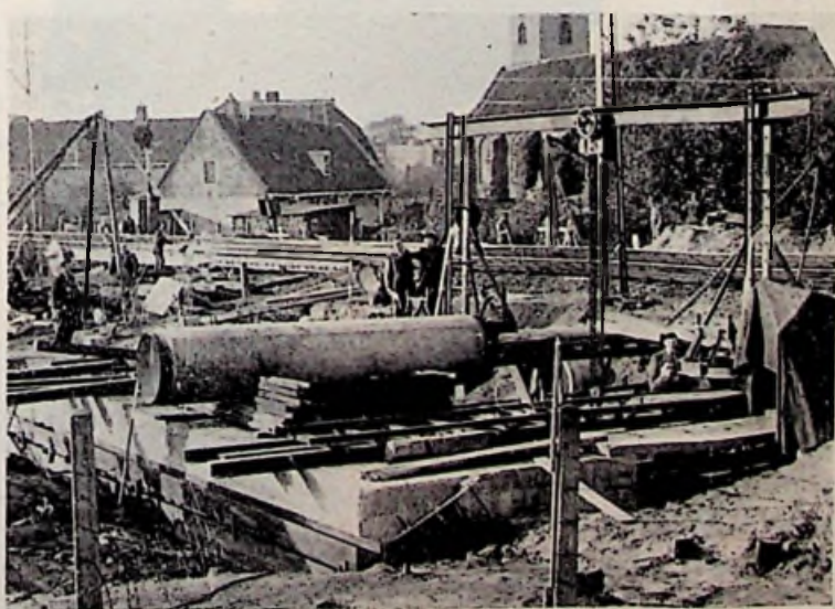
Een buisgedeelte ligt klaar om gesteld te worden. Duidelijk zijn de zware, ijzeren balken te zien, die door trekstangen met de andere zijde van de spoordijk zijn verbonden en die moeten zorgen dat het betonblok op z'n plaats blijft
