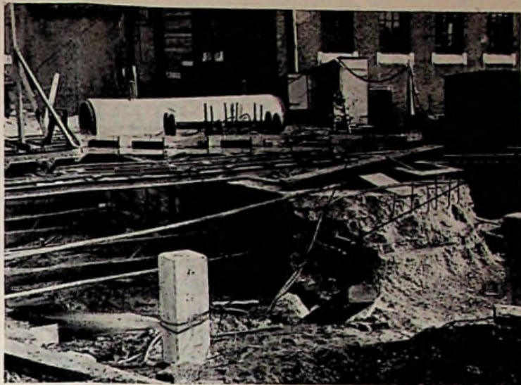
Een gedeelte van het betonblok is reeds opgeruimd om een plaats vrij te maken voor de fundering station Sloterdijk
